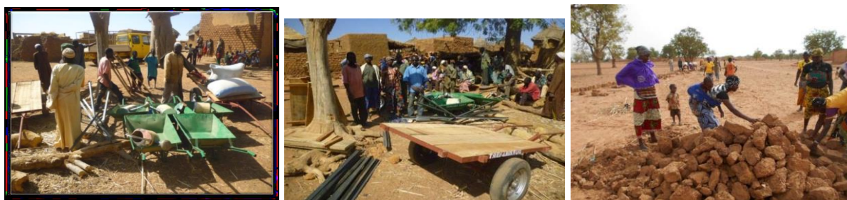
Don du matériel requis et ramassage des cailloux pour la construction des diguettes
